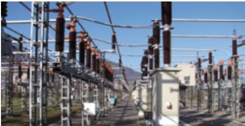
Es 400 kV Horná Ždaňa AIS 400 kV rozvodňa
