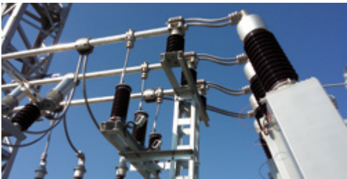
Es 400 kV Spišská Nová Ves terciárne vinutie výk. transformátora
