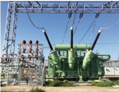
Es 400 kV Levice výkonový transformátor 400/110 kV 250MVA
