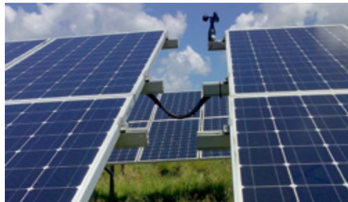
Fotovoltaická elektrárň Drahovce
