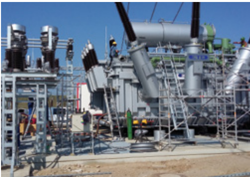
Es 400 kV Spišská Nová Ves výkonový transformátor 400/110 kV 250MVA
