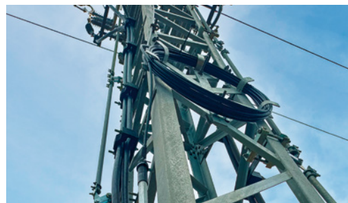
Prechod káblového vedenia VN na vdušné vedenie VN v obci Lakšárska Nová Ves
