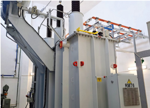
Nový transformátor Duslo Šaľa
