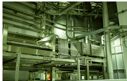
Parogenerátor a impulzné trubkové línie AE Mochovce
