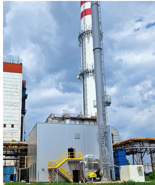
Duslo Šaľa – kotolňa s novým kotlom K8
