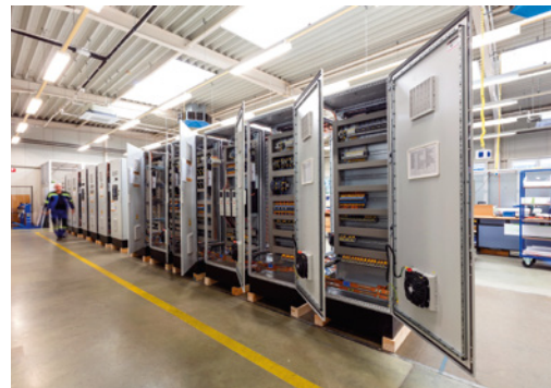
Montážna hala prevádzky výroby rozvádzačov
