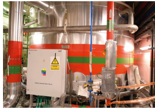
Nádrže havarijných systémov AE Mochovce
