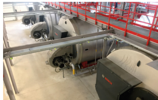
Kogeneračné jednotky v martinskej teplárni
