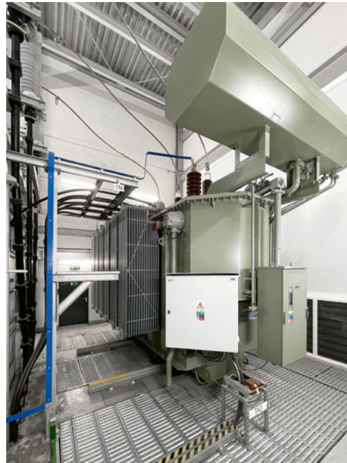
Zapúzdrené stanovište transformátora ES Čulenova
