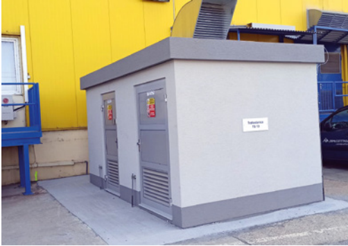
Trafostanica TS 13, Essity Slovakia
